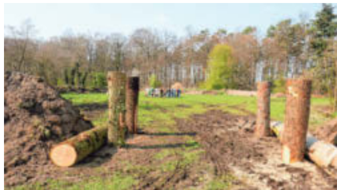
Festgerammt in der Erden: Das Dorf ist durch einen Erdwall eingerrahmt; die Pfosten deuten das spätere Eingangstor an.
